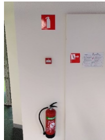
Brandblusser en brandalarm
